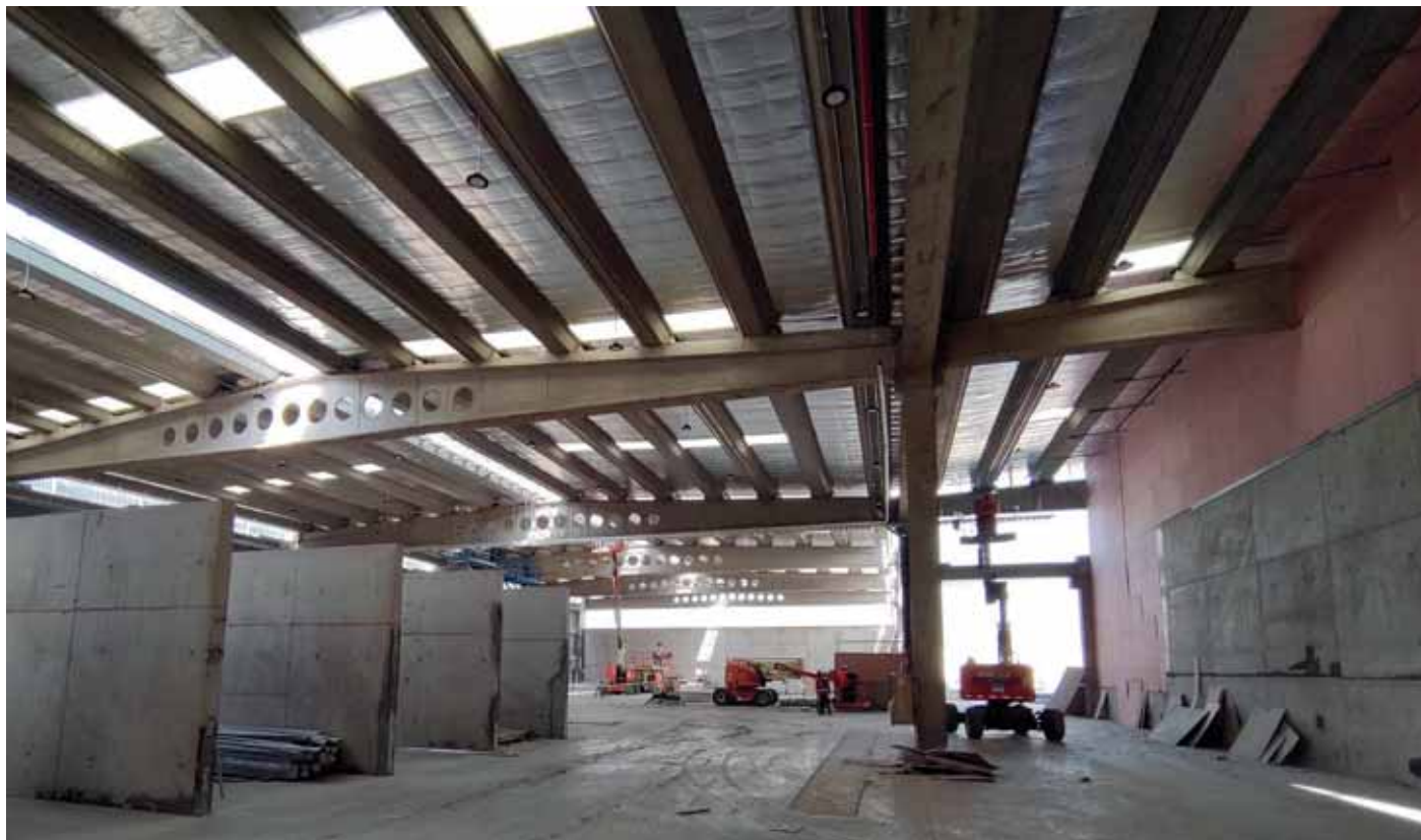
Entre los desafíos del proyecto estuvo el montaje de los elementos prefabricados y su coordinación con las obras civiles.
