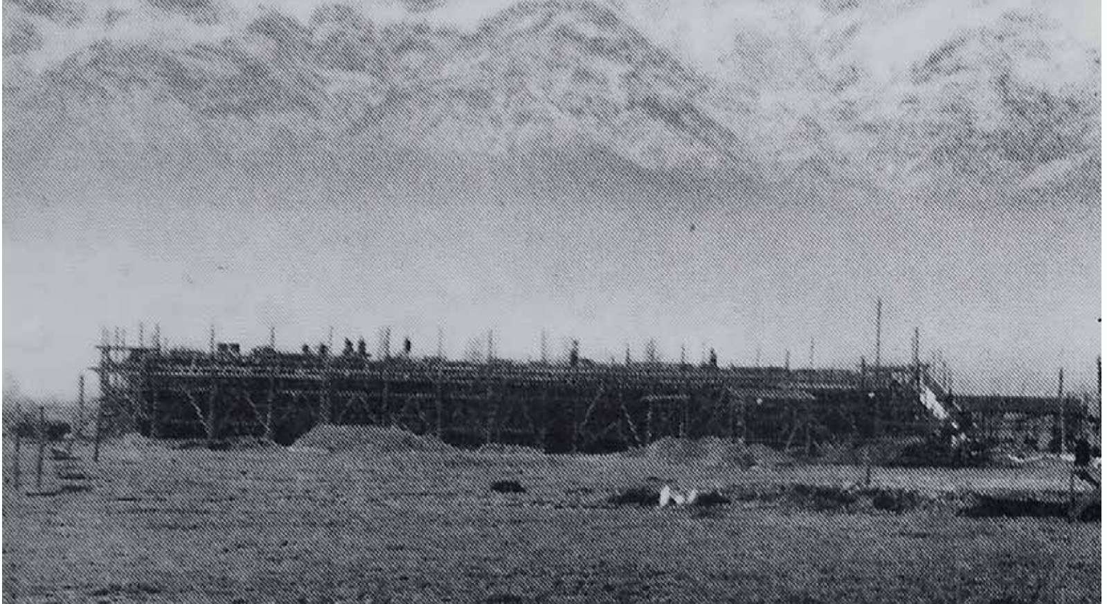
Construcción del Departamento de Investigaciones Científicas y Tecnológicas de la Pontificia Universidad Católica, 1963. Campus San Joaquín. Al fondo se ve el pabellón de talleres de proyectos y a la derecha los laboratorios de mecánica y metalurgia. Fotógrafo desconocido.
